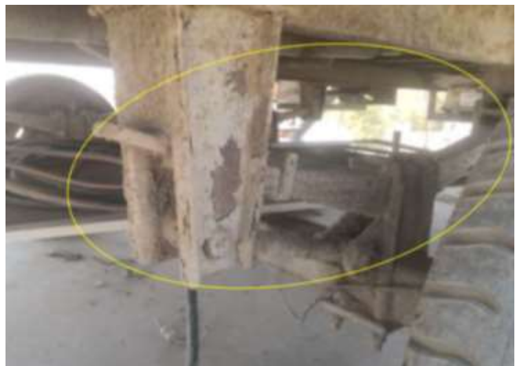
Se muestran imágenes del conjunto de suspensión, donde se realizará el mantenimiento correctivo (antes de limpieza externa y pintado de estructura)
