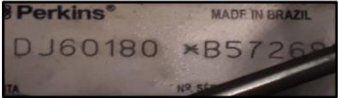
Placa del motor del grupo electrógeno KEYPOWER de la EPM5 Nazca
